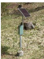
Monitoreo de aguas subterráneas
